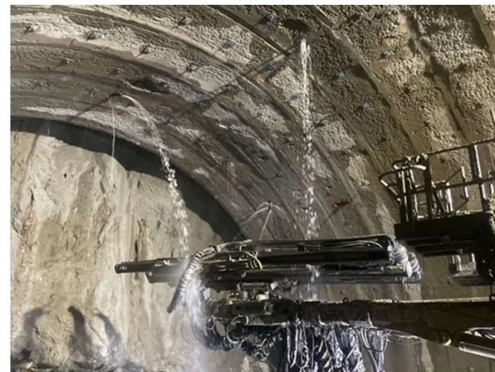
写真2 ロックボルト孔からの湧水状況
