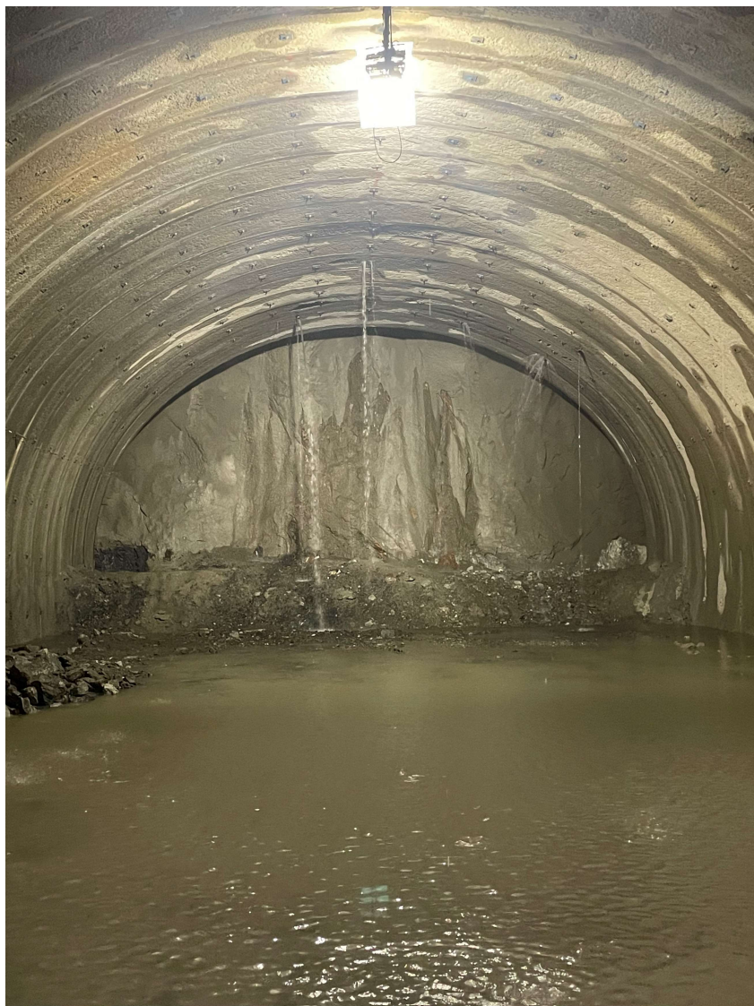
写真1 ロックボルト孔からの湧水と孔内の水没状況
