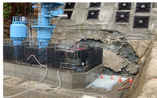
写真2 崩壊した切土法面
