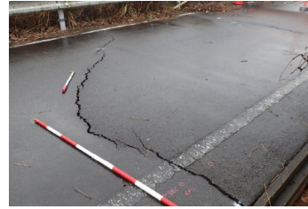
市道路面クラック
