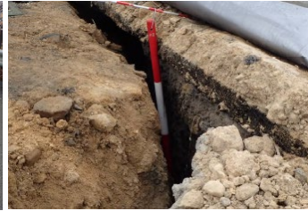
法肩部クラック
