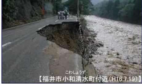
写真② 国道158号 崩落
