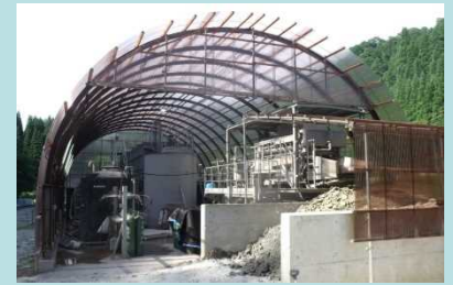
濁水処理施設
