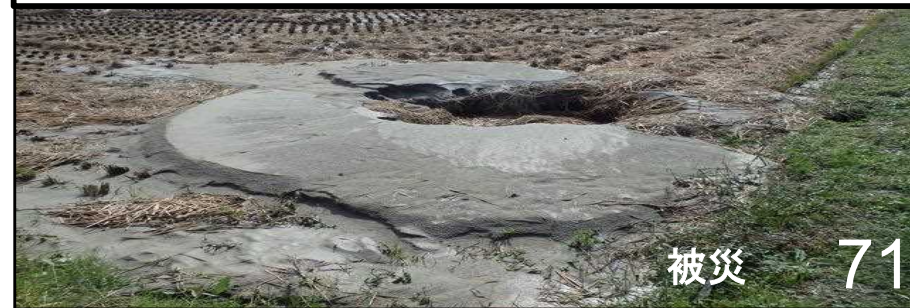
漏水事例(八幡市上津屋)
