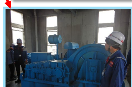
草谷川水門のゲート直接操作訓練(操作室)
