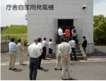
停電時に事務所の電気を確保する（庁舎自家用発電機の電源切り替え、起動訓練）
