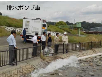
台風や大雨に溢れたり、溜まった水を排水。人力で運搬できる排水ポンプ（4台）と電気を作る発電発電機を搭載（排水運転を実施）
