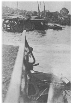
真二つに折れた神崎橋 (兵庫県と大阪府の境)
