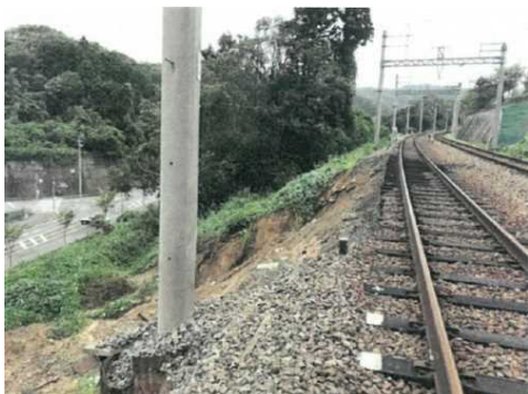
北区山田町 法面崩壊（神戸電鉄の法面）
