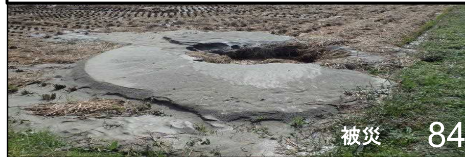
漏水事例(八幡市上津屋)
