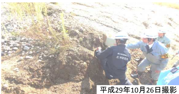
盛土(上部)の亀裂調査
