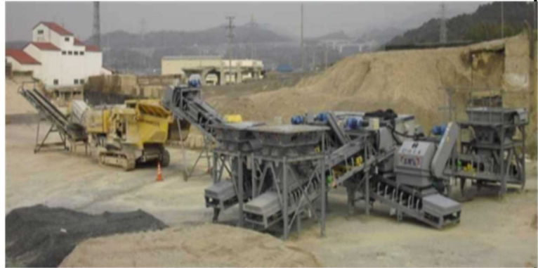
土砂混合システム近景【土壤くん】
