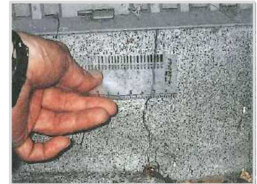
クラックスケールによる基礎のひび割れ幅の計測
