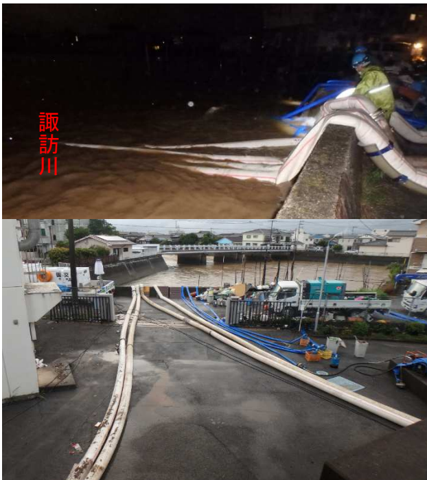
図-3 左ホース2本 道路冠水面→諏訪川へ 右ホース2本 貯留槽→諏訪川へ
