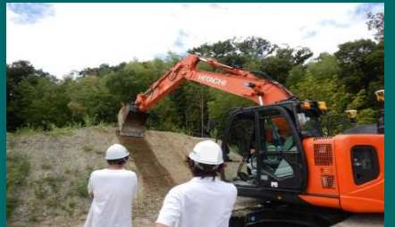
施工データの建機へのセッティングと ICT建機実技 (MCバックホウによる法面整形)
