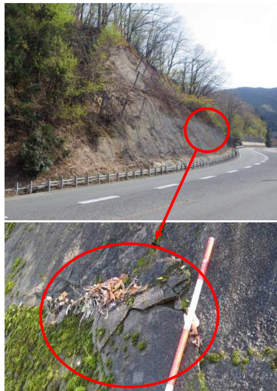
写真-3 施工箇所全景と法面の損傷状況
