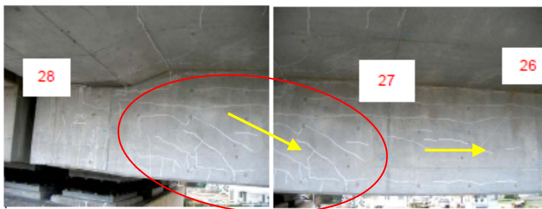
写真5 - 1 . 山中川高架橋 P9 端支点近傍のひび割れ
