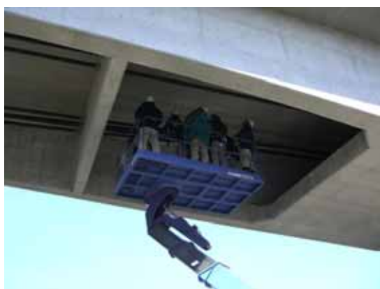
写真3 - 12 . 山中川 P8 ~ P9 開断面部
