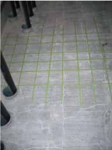
写 真 3 - 2 2 . P 1 2 横 桁 の 損 傷 ( 網 線 は 鉄 筋 位 置 )
