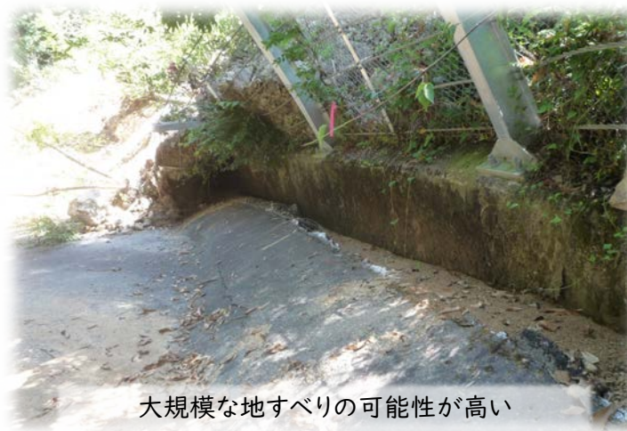
埋設管が破損しているかもしれない
