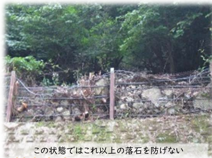
支柱が著しく腐食している
