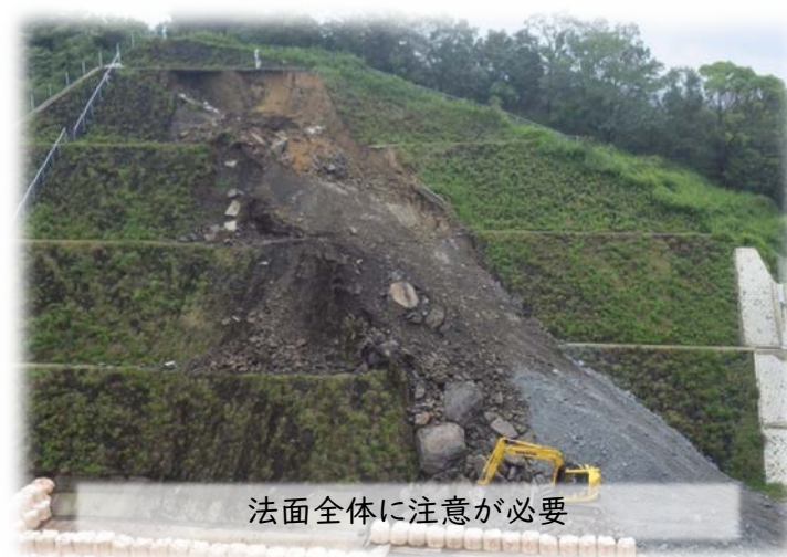
流れ盤構造の区間は崩れやすい
