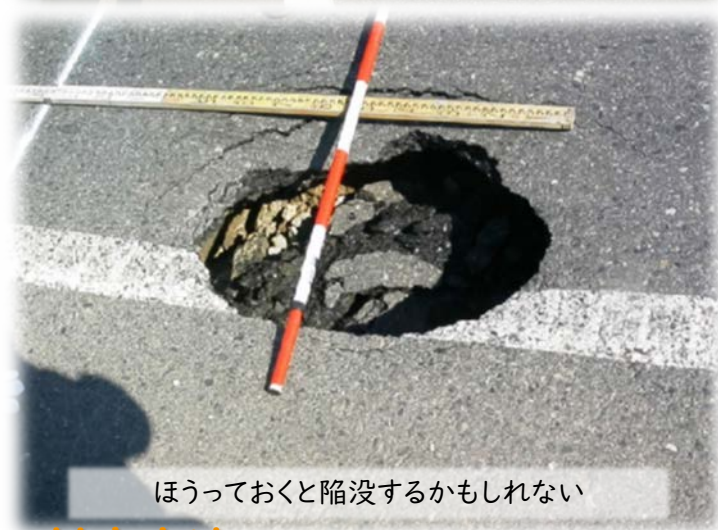
亀裂の入り方に注意
