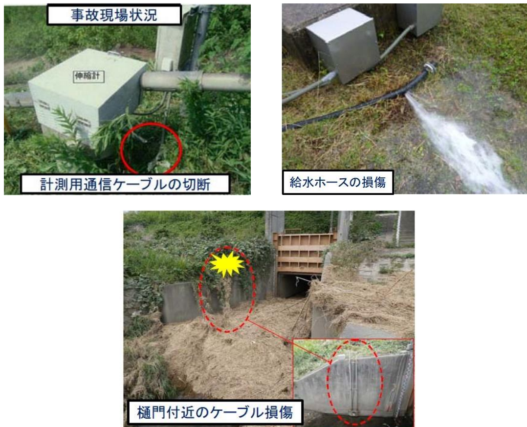
写真 2.4 通信ケーブルや給水ホースの切断事故例（参考写真）
