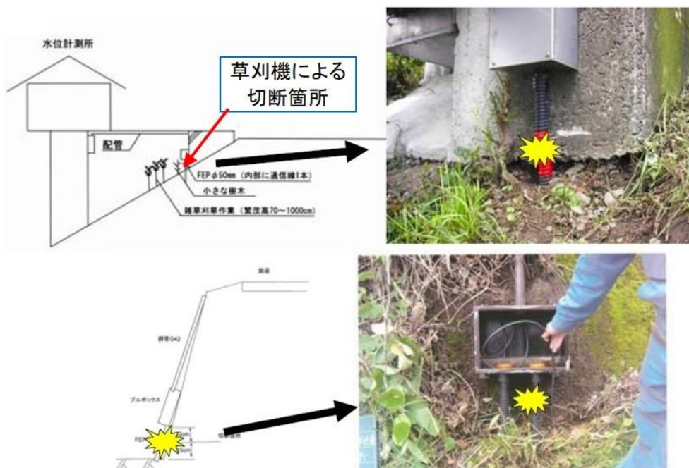
写真 2.3 水位計測所の通信ケーブルの切断例（参考写真）
