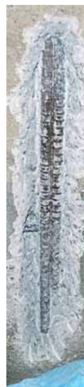
写真 3.1 鋼材の腐食状況（干満帯部）
