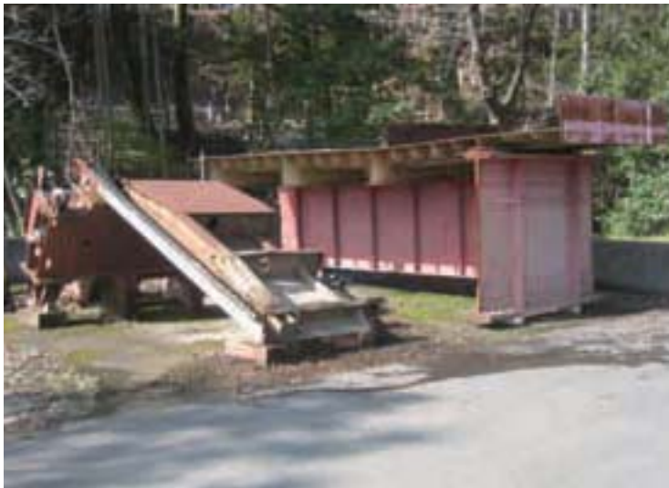
瀬田川洗堰扉体の一部及び旧宇治川御幸橋の橋梁上部 (経年による劣化)
