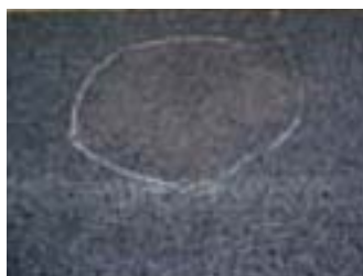
アスファルトの溶け出し
