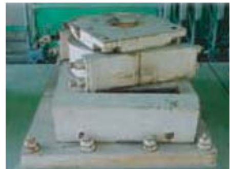
道路橋の支承部(被災による損傷)
