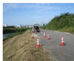
陥没発生箇所
