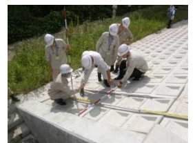
沈下・陥没の確認
