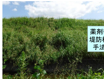
高茎草本が繁茂した堤防法面【当初】
