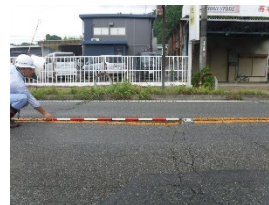
堤防天端の沈下状況
