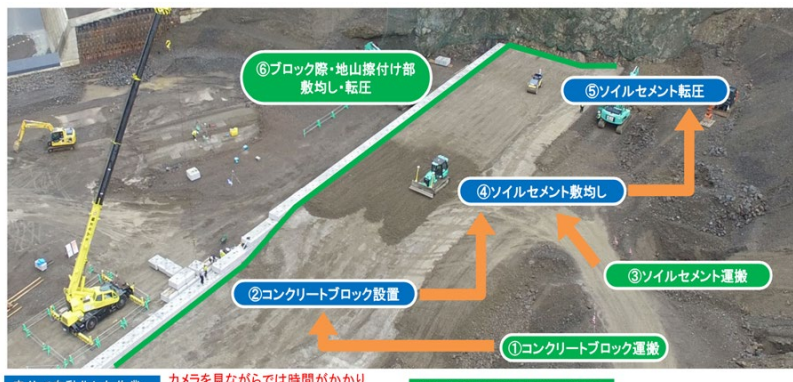
赤谷地区のICT建機(MC/MG)を活用した敷均し・転圧 ・コンクリートブロック・ソイルセメント運搬 (R5)
