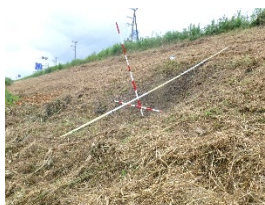
堤防のり面の陥没状況
