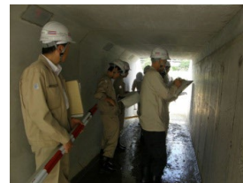
露筋・漏水の確認
