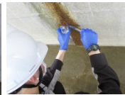
ひび割れ部析出物 採取状況
