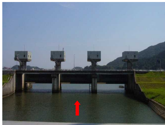
図-2.37 鮎田水門（相野谷川合流点）
