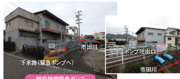
野田樋門緊急ポンプ
