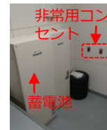
利用施設における再生可能エネルギーの導入と蓄電池の設置による非常時における電源の確保
