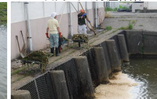
スクリーンの除塵作業
