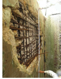
内部の鉄筋が露出した橋梁
