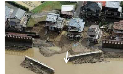
平成23年台風12号での相野谷川の輪中堤(特殊堤)の 転倒状況(高岡地区)
