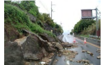
写真1 法面崩落状況(串本町和深地先)
