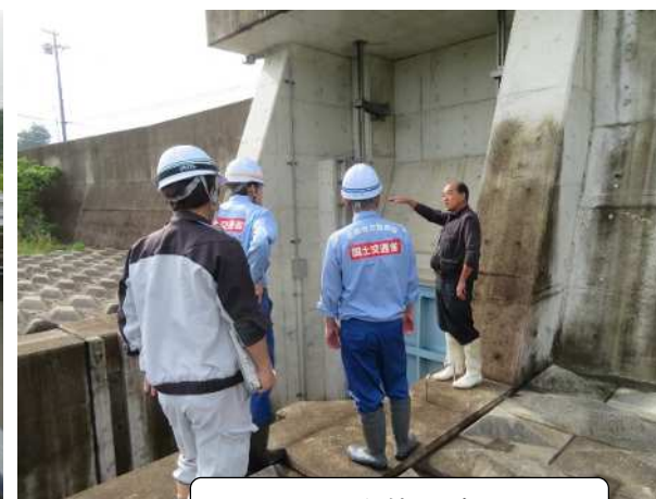
不具合箇所確認
