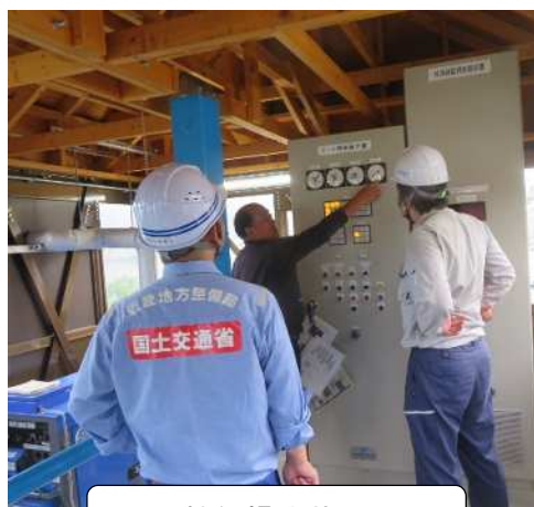
機側操作状況
