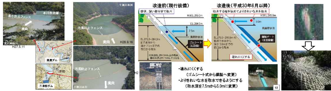
風屋ダム・二津野ダム 濁水防止フェンス (出典：第14回熊野川の総合的な治水対策協議会)
