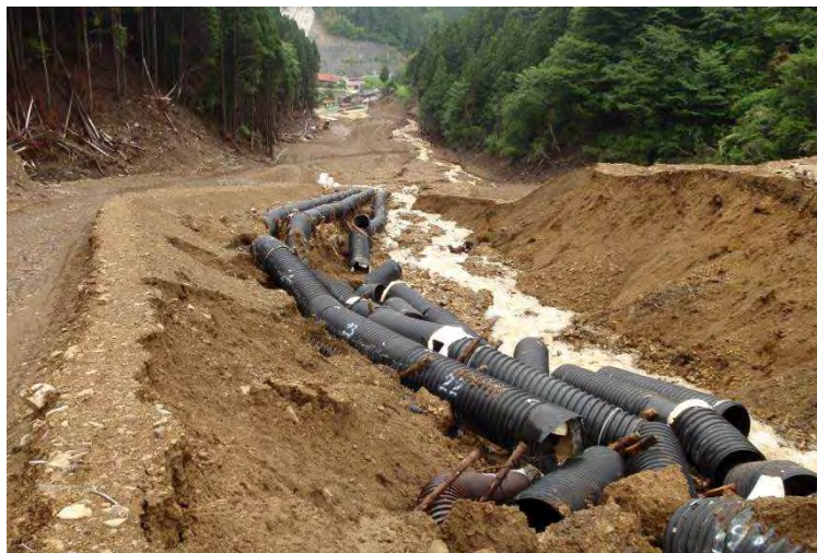
平成 24 年台風 4 号、5 号時の排水管の破損状況（北股地区）
