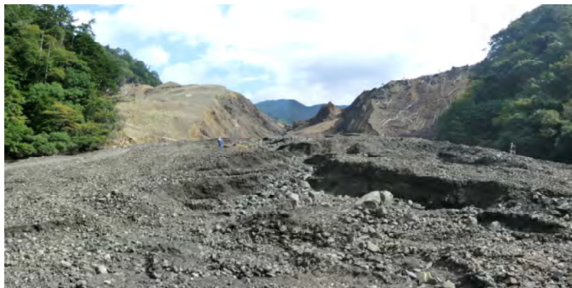
仮排水路水路下流端の侵食状況 平成 24 年 10 月
