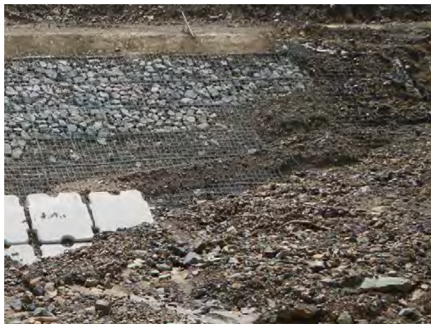
仮排水路工への土砂堆積状況（赤谷地区）
