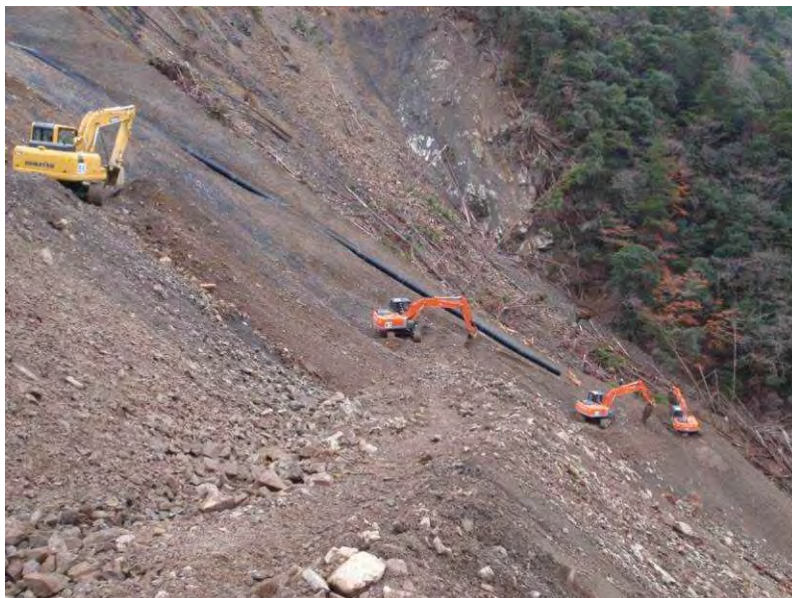
バックホウによるシュート部の改良土撒き出し状況（栗平地区）
