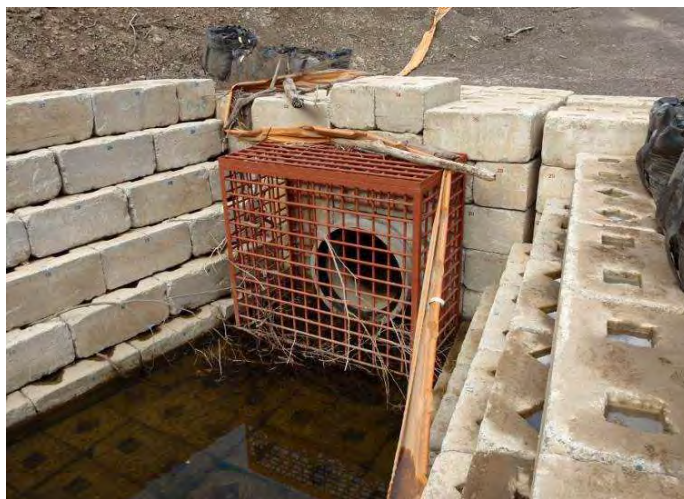
ブロックによる補強後の暗渠排水管の呑口部（赤谷地区）
