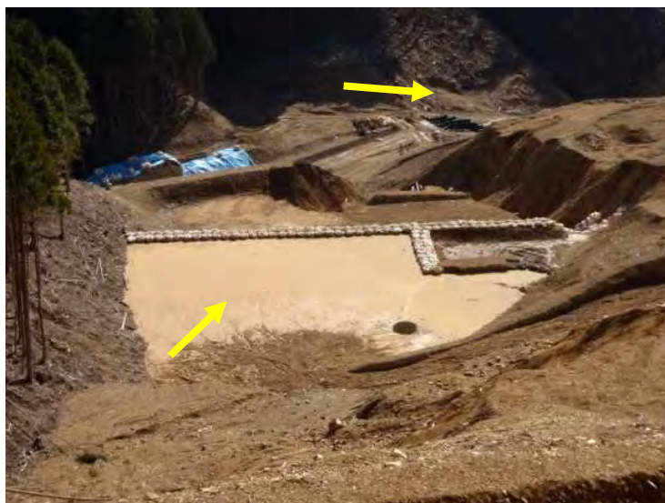
堆積工内の縦樋（北股地区）
