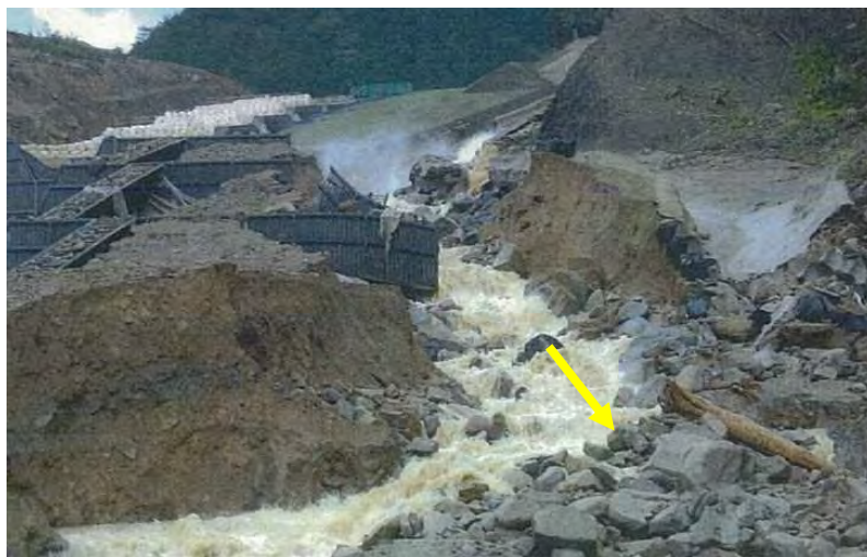
袖を貫入しなかった場合の侵食による破損（熊野地区）
