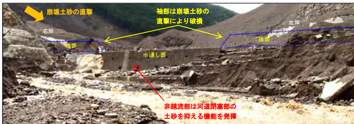
崩壊土砂の直撃により袖部は破損したものの、非越流部が機能を発揮した事例 (平成 26 年台風 11 号時の赤谷地区の 2 号砂防堰堤)
