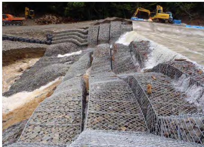
下流端の護床工沈下状況（栗平地区）
