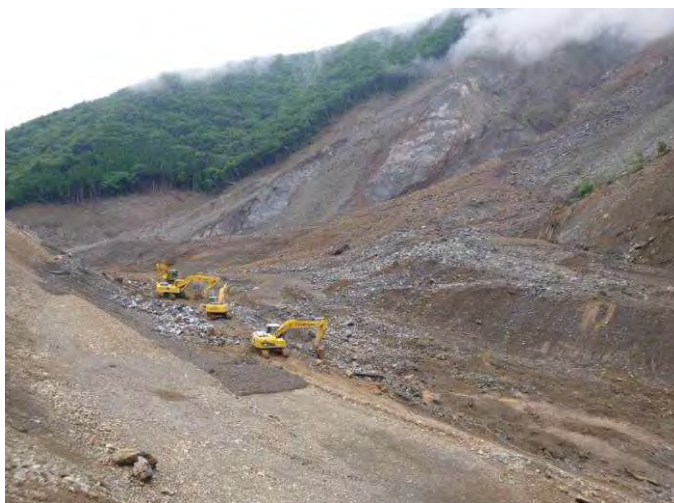
仮排水路の埋没状況（赤谷地区）
