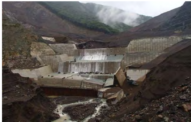
下流河道の侵食による垂直壁の転倒状況（赤谷地区）
