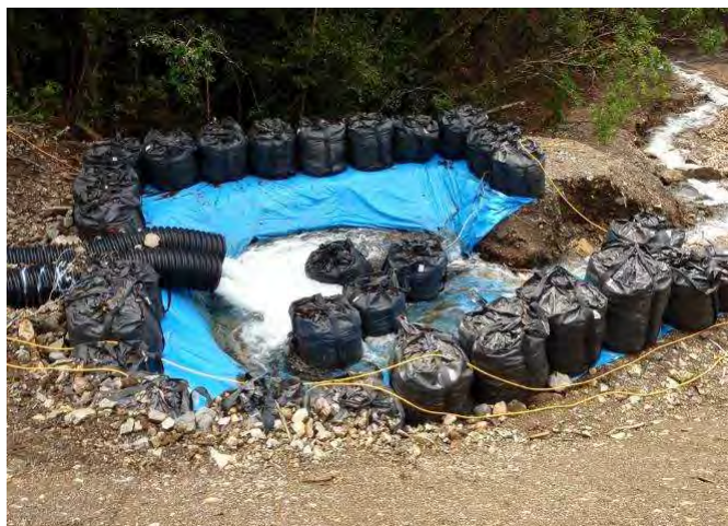
排水ホース設置吐口部の状況（栗平地区）
