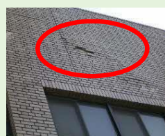
外壁等の剥落の 恐れ
