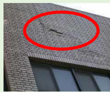
外壁等の剥落 のおそれ
