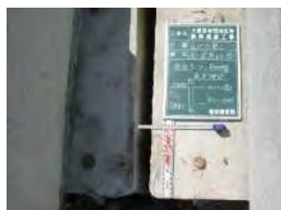
(目地開き状況)
