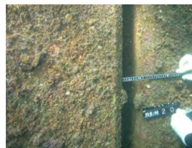
目地の開き ケーソン上部
