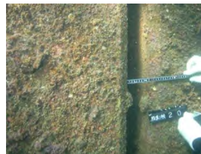
目地の開き ケーソン上部
