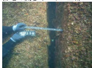
目地の開き ケーソン上部
