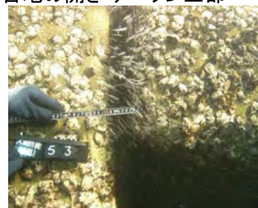
目地の開き ケーソン上部
