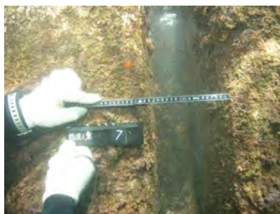
目地の開き ケーソン上部
