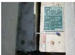
(目地開き状況)
