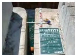
(目地開き状況)
