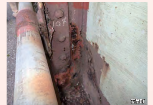
主桁の腐食状況
