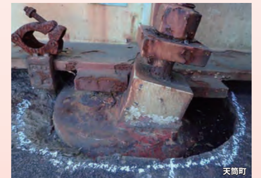
支承の沈下傾斜状況
