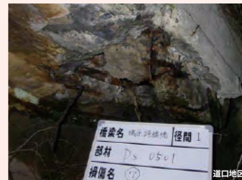
床版の剥離・鉄筋露出
