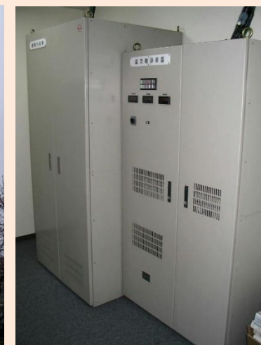
通信用直流電源装置
