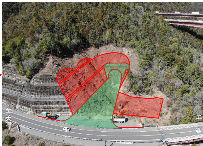
法面对策 現地状況(令和8年3月時点)
