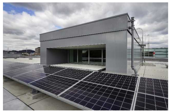
屋上（太陽光発電）
