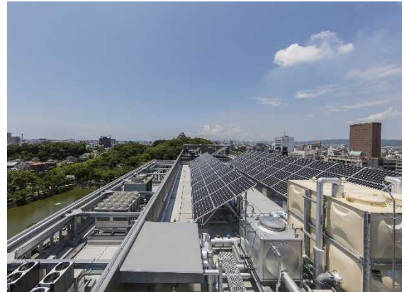
屋上（太陽光発電）
