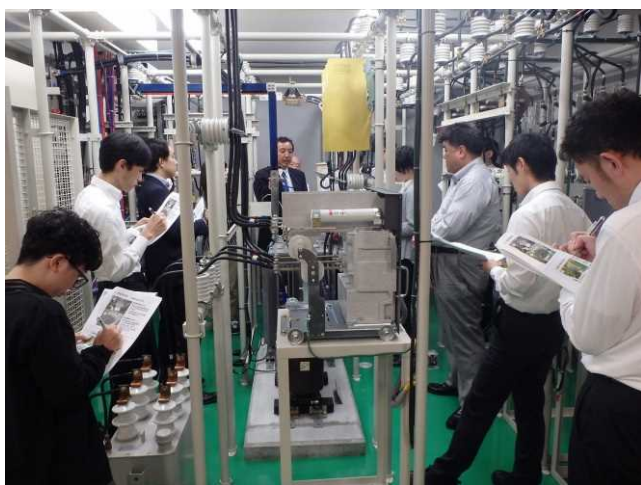
受変電設備実習機で内部機器説明
