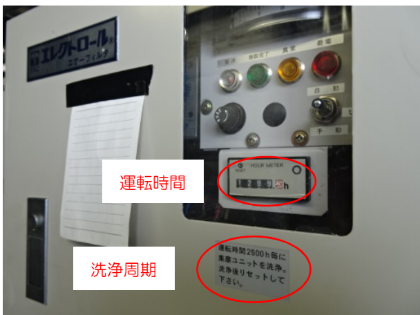
■空気調和機のフィルターユニット
