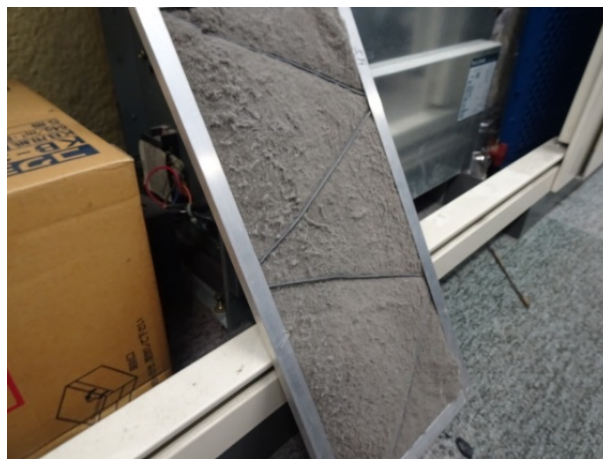
■フィルターが目詰まりしている状態
