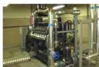
自家発電設備
