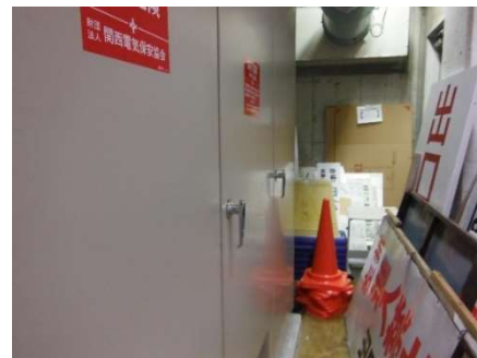
電気室の「倉庫化」
