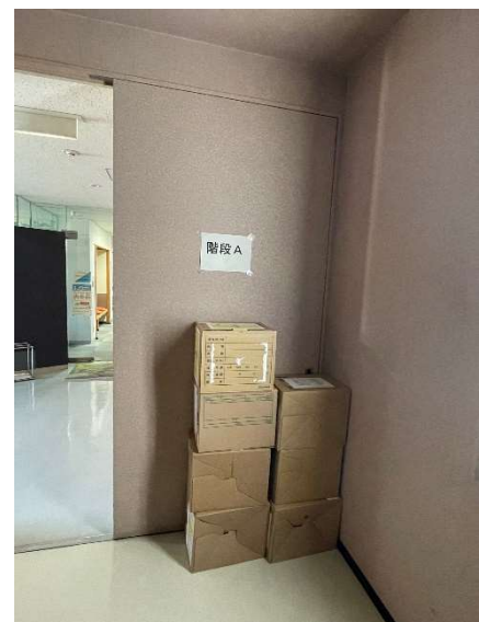
防火戸が閉まらない・・・
