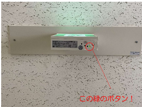
誘導灯のバッテリー確認！
