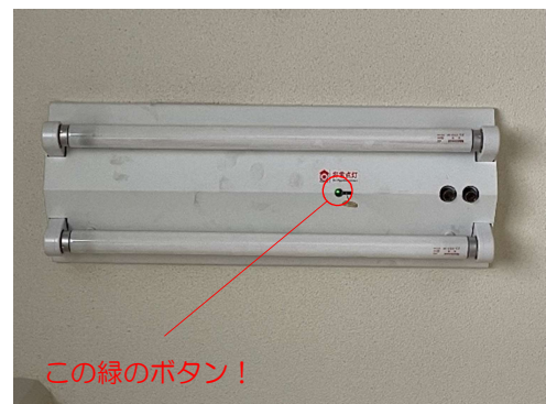
非常用照明のバッテリー確認！
