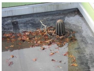
ルーフトレン未清掃による 水たまり
