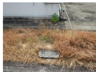
屋上緑化のメンテナンス不足
