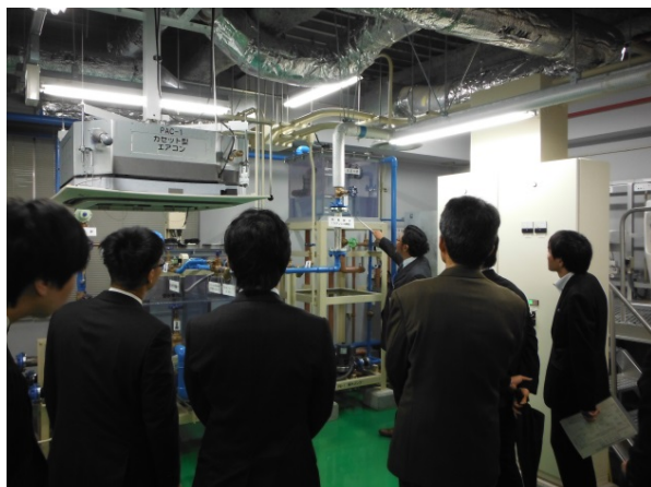
給排水設備の実習風景 (受水槽における給水動作の説明)
