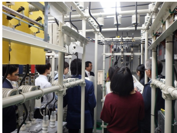
実習室の受変電設備に入り電気機器を説明する様子
