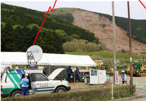
衛星通信車による 被災箇所の監視
